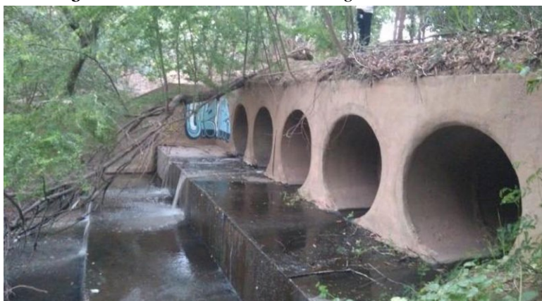
Figura 3 – Boca de lobo ou canal de esgoto sem tratamento
