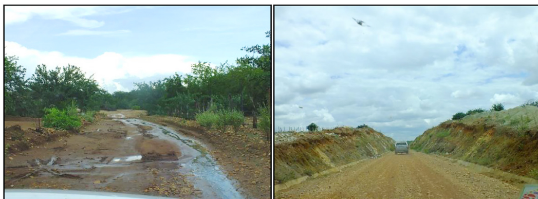
Figura 4 – Fotografias destacando as condições da Estrada de acesso ao P. A. Cachoeira e Malhete, Paulistana-PI
