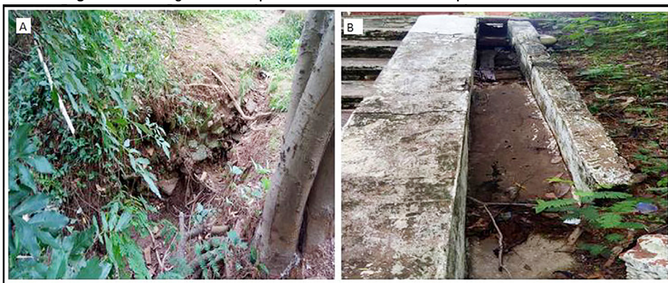
Figura 7 – Fotografias dos processos erosivos do Parque Encontro dos Rios
