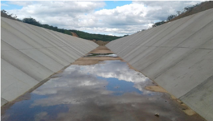
Figura 02 - Trecho do Cinturão das Águas do Ceará – CAC, no Assentamento 10 de Abril, em Crato – CE
